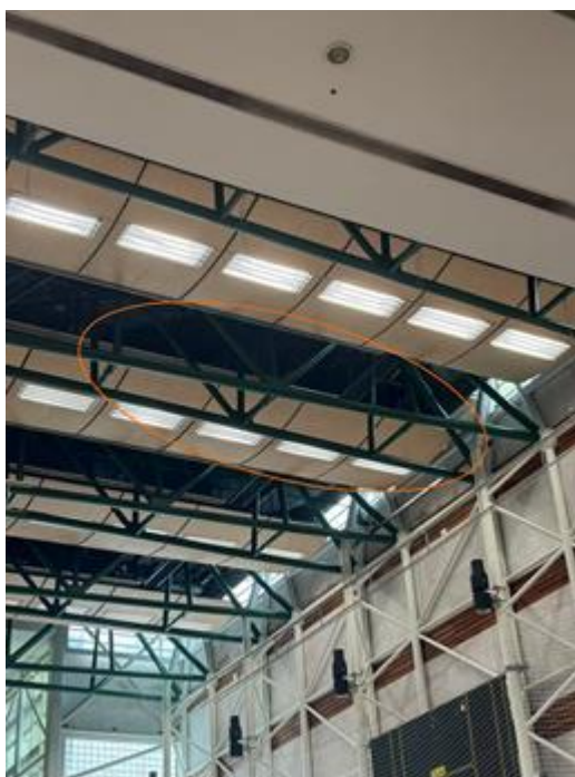
圖四：氹仔運動場室內場館(漏水位置)
