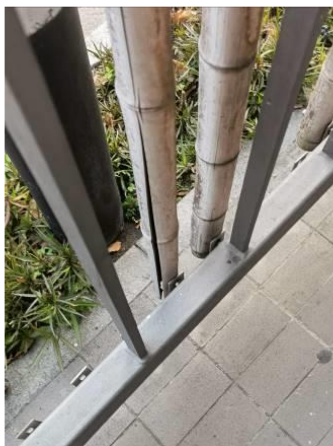
氹仔嘉樂庇總督馬路行人路 裝潢的竹出現破損
