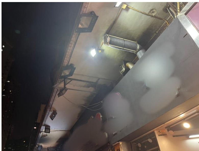
不少外賣店舖均營業至凌晨，居民即使到了凌晨時份仍飽受油煙困擾。
