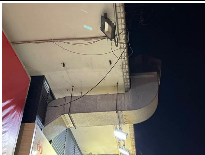
加強巡查氹仔中心區食肆排氣設備
