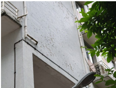
永寧廣場大廈外牆飾面掉落
