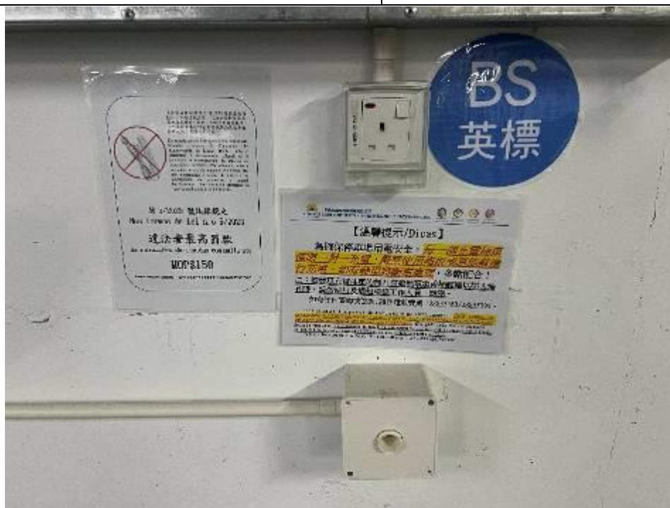
氹仔中央公園公共停車場電單車充電位
