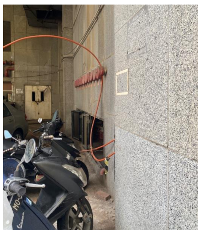
圖三 裸露的電線
