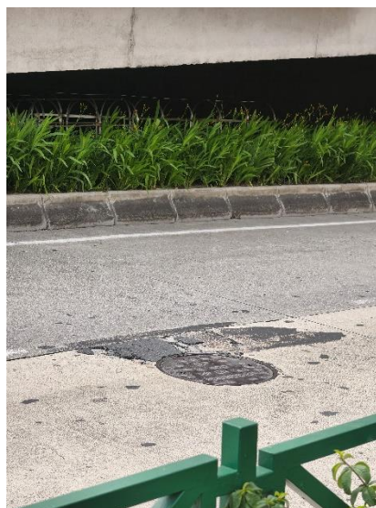
何賢紳士大馬路出現裂紋及渠蓋下陷 道路問題。
