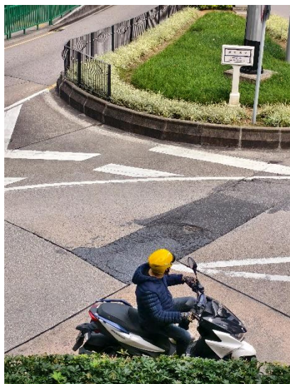
位於關閘廣場行人天橋底下的坑洞， 電單車駕駛者要“退避三分”。
