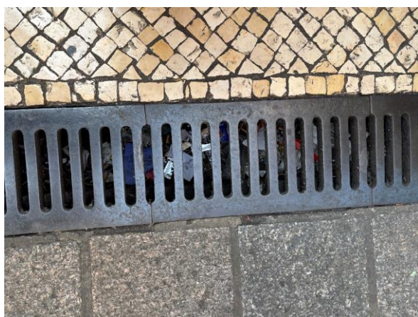
溝渠垃圾堆積
