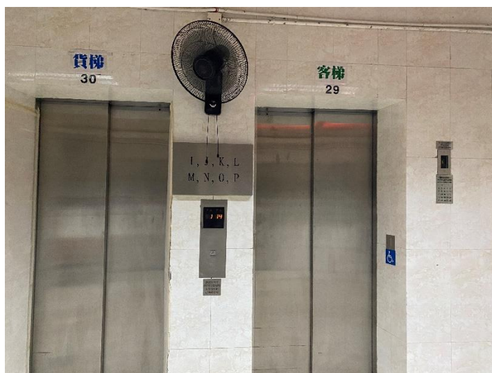
圖二 樂群樓升降機故障頻繁
