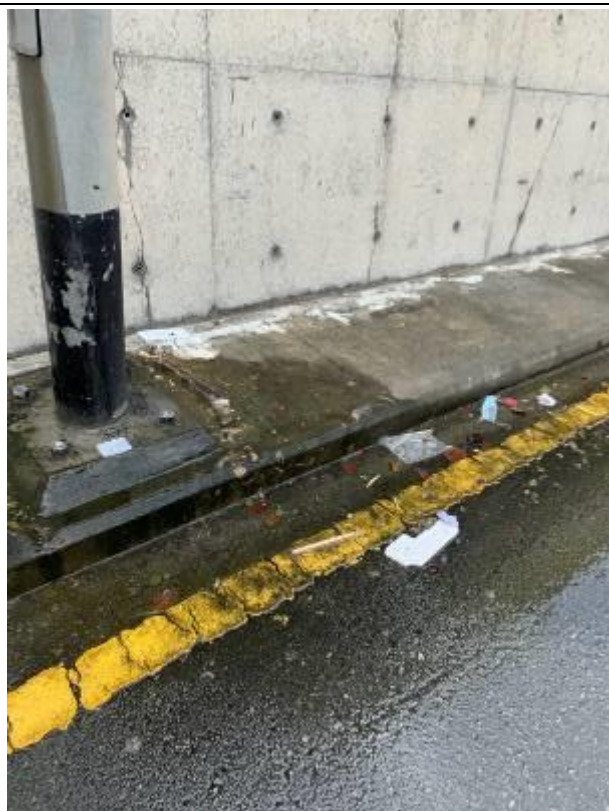
擔憂水從燈柱滲出，容易發生漏電情況
