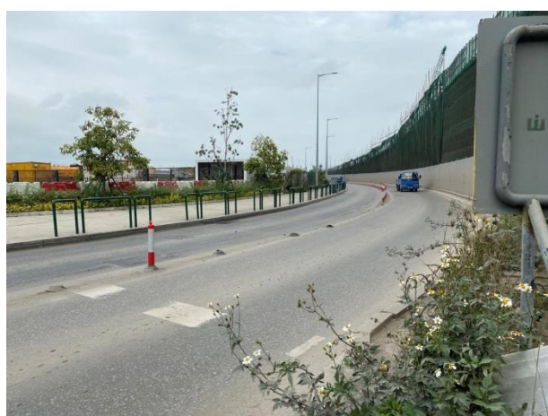
彈力棒出現損壞和缺失
