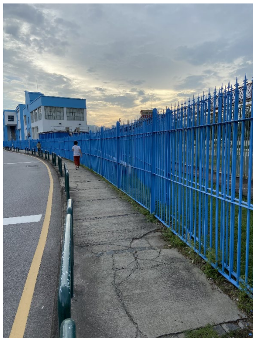
行人路路面有裂縫及凹陷
