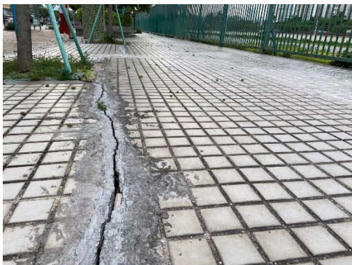
休憩區地面出現裂縫
