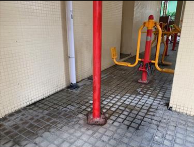
地面上不明來源的水，令設施加速損耗。
