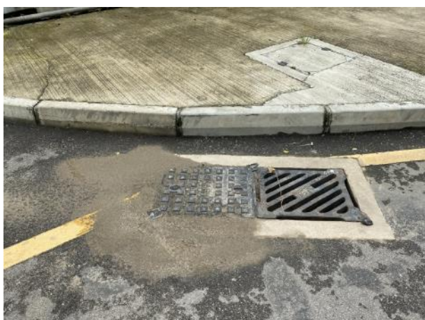
鄰近的雨水渠周邊存積沙石 2020 年 5 月 27 日攝
