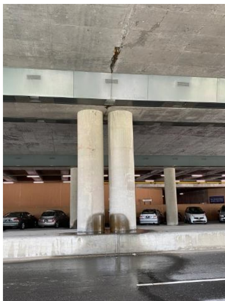
隧道上方出現漏水 2020 年 5 月 27 日攝
