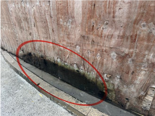
圖三：被雨水侵蝕導致發霉
