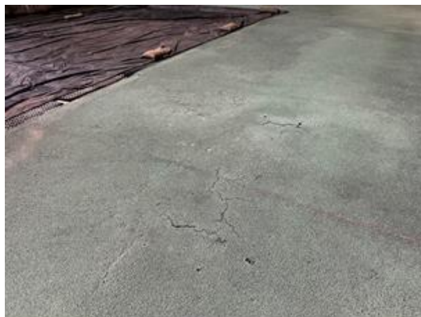
圖四：地面出現裂痕
