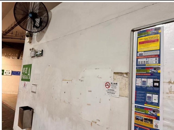
圖一. 站內牆壁污漬明顯、油漆剝落，令環境顯得凌亂
