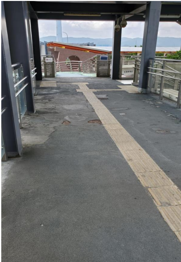
圖五：行人天橋上出現大大小小剝落及形成凹凸的情況
