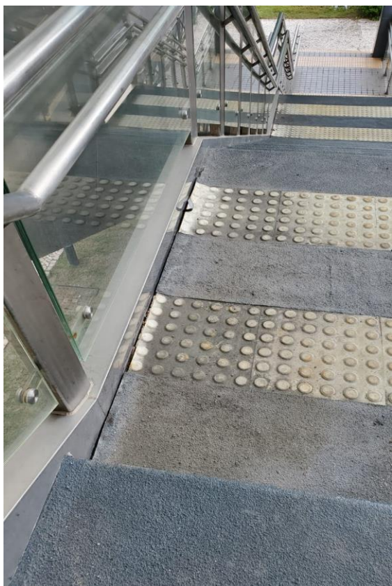
圖一：行人天橋樓梯的地膠出現高低不平的狀況
