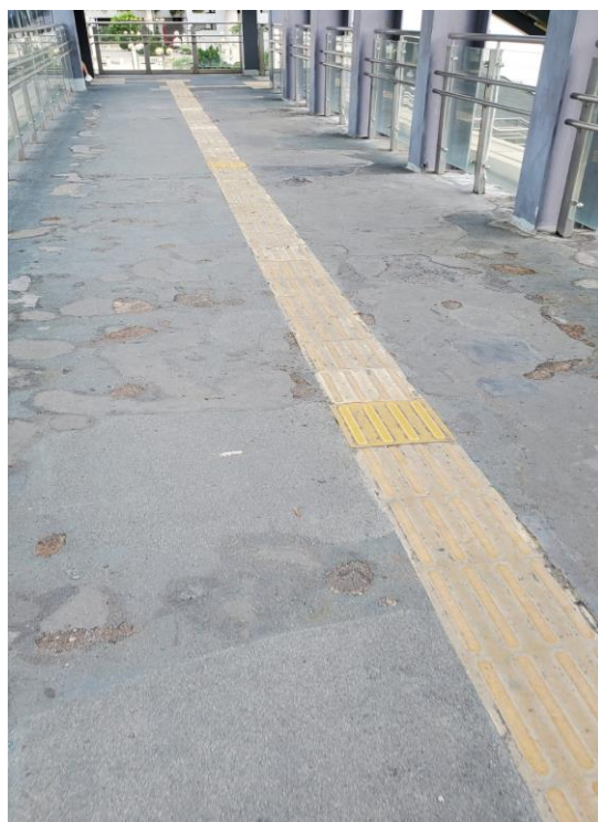
圖四：行人天橋上出現大大小小剝落的情況
