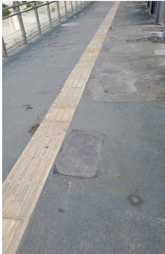
圖六：行人天橋上出現大大小小剝落及形成凹凸的情況
