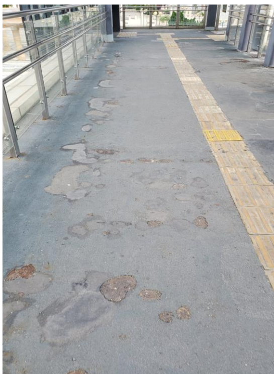
圖三：行人天橋上出現大大小小剝落的情況
