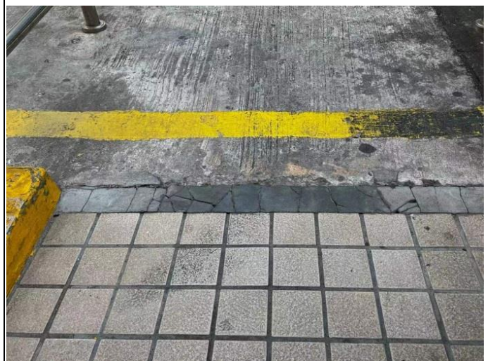
衛生中心近山體一則的無障礙設施 坡道地面已裂開並鬆脫 2021 年 12 月 30 日攝
