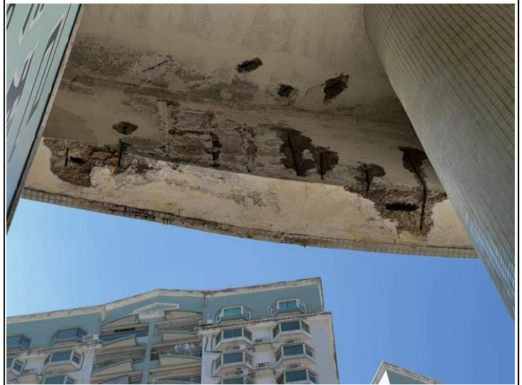
建築物天花已出現混凝土剝落 2021 年 12 月 30 日攝
