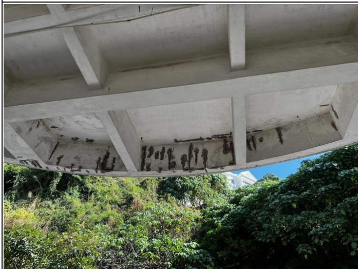
鋼筋外露情況 2021 年 12 月 30 日攝
