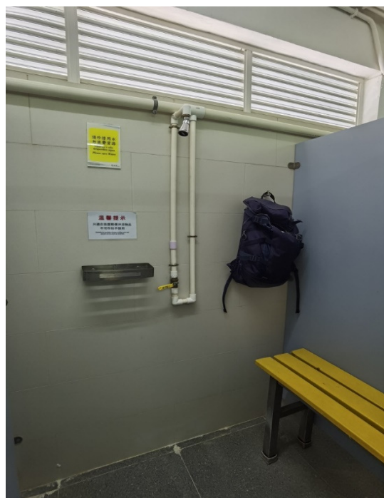
圖一 黑沙泳池淋浴間設備不合理
