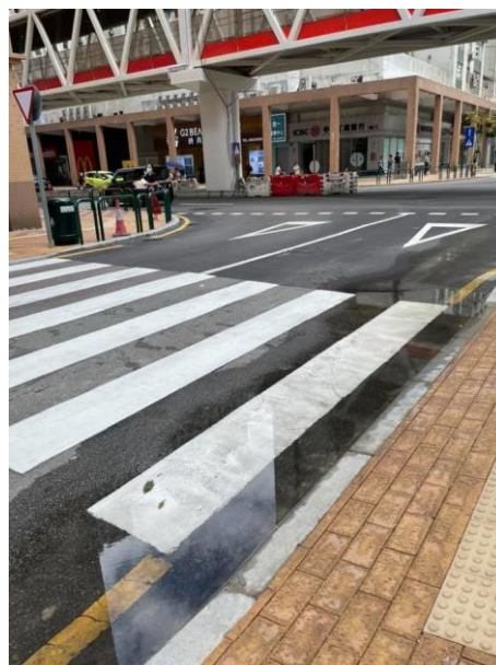
部份位置雨後出現積水情況
