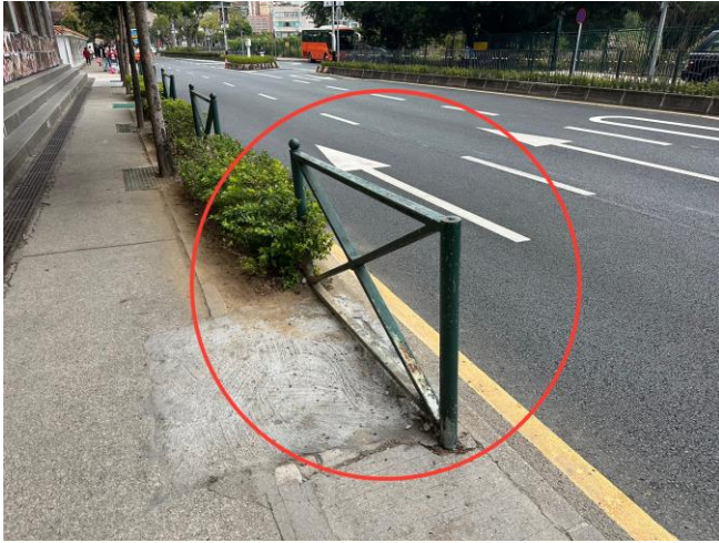
圖五：奧林匹克大馬路，圍欄破損
