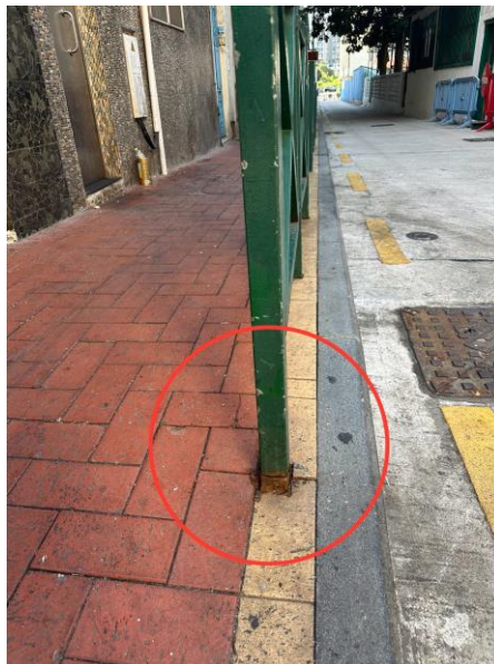
圖四：律政司街的圍欄出現鏽蝕
