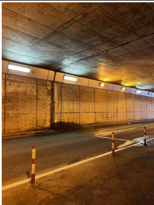
水沿著牆流出車道，不利駕駛者
