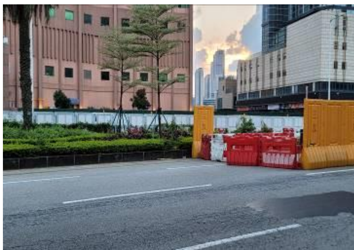
圖四 圍板隔絕有效隔絕行人強行過馬路
